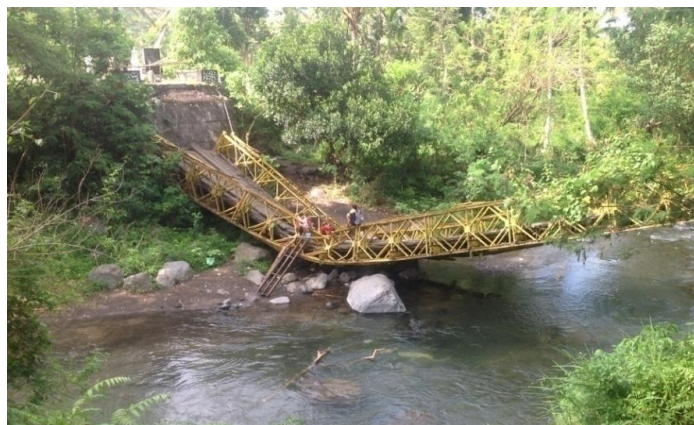
Gambar 7. Kerusakan jembatan oleh truk yang memuat pasir atau batu melebihi kapasitas sehingga terputusnya jalur transportasi di Banjar Luah, Sidemen, Karangasem. (Dokumentasi : I Wayan Setem, 2018).
